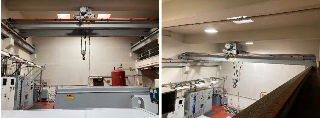
OLEPS Overhead Crane
